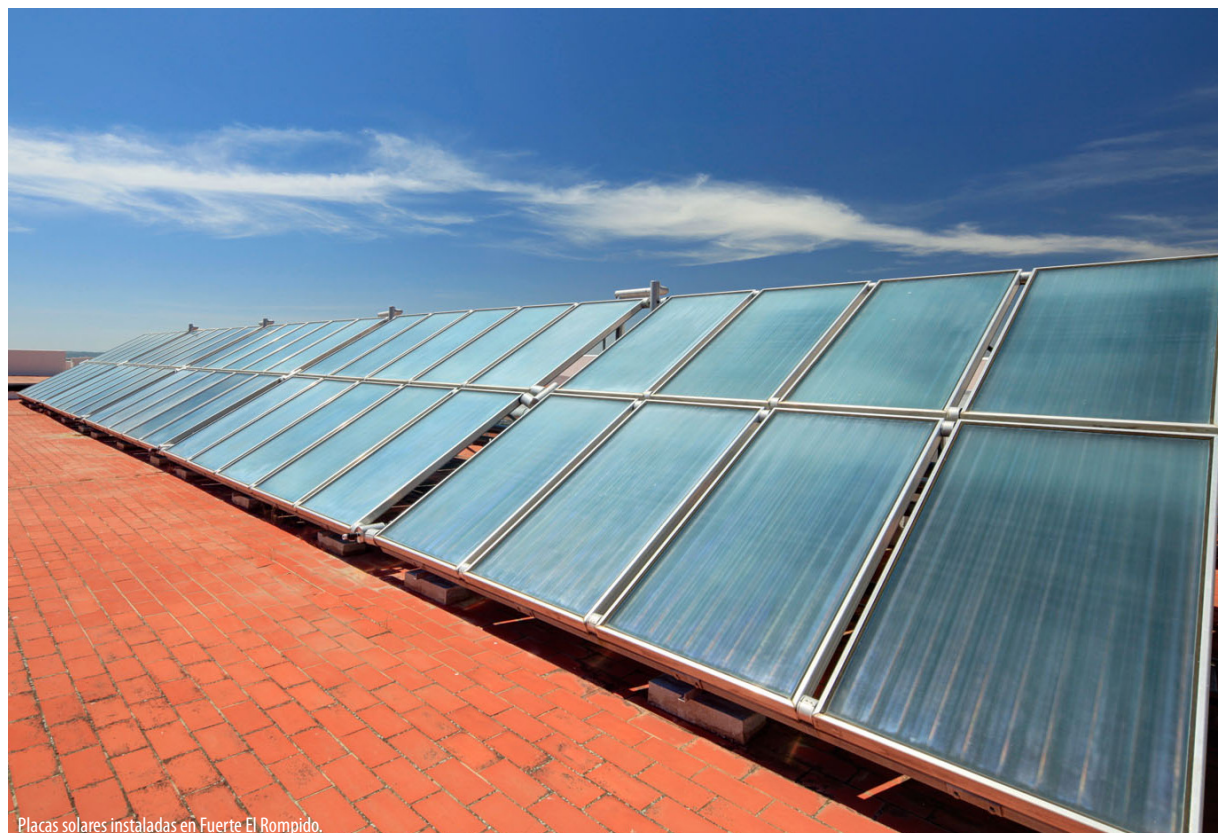
Placas solares instaladas en Fuerte El Rompido.
